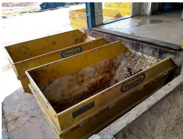
Figura 7. Recipiente utilizado para armazenar e encaminhar os resíduos para a vala séptica
