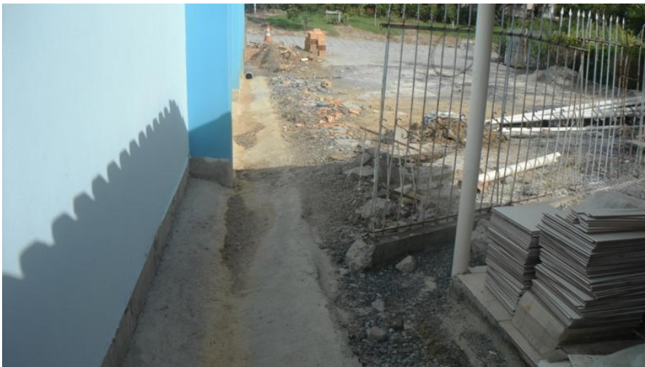
Buraco na cerca e restos de entulhos de construção – Janeiro 2013
