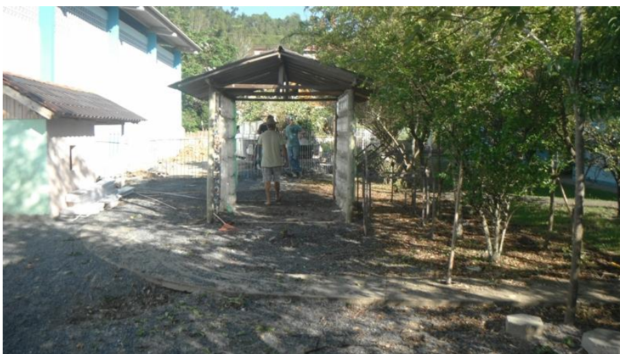
Casinha com estrutura podre – Janeiro 2013
