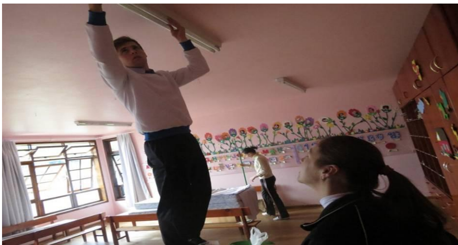
Instalação elétrica vistoriada – Agosto 2013
